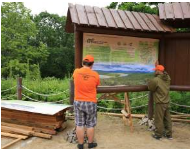
Рис. 67. Группа из трех стендов расположена на автомобильной парковке при входе на территорию кордона
